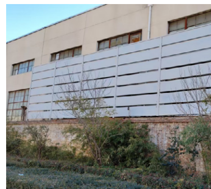
曲阜电缆临街车间外墙设声屏障
