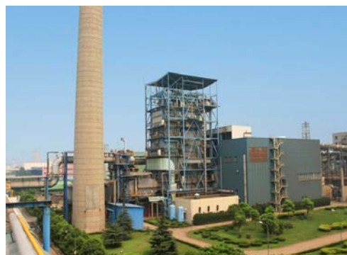
高炉煤气锅炉
