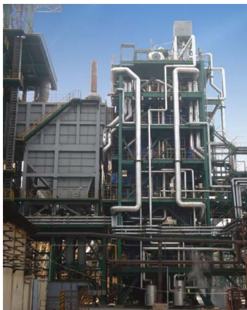
干熄焦余热锅炉
