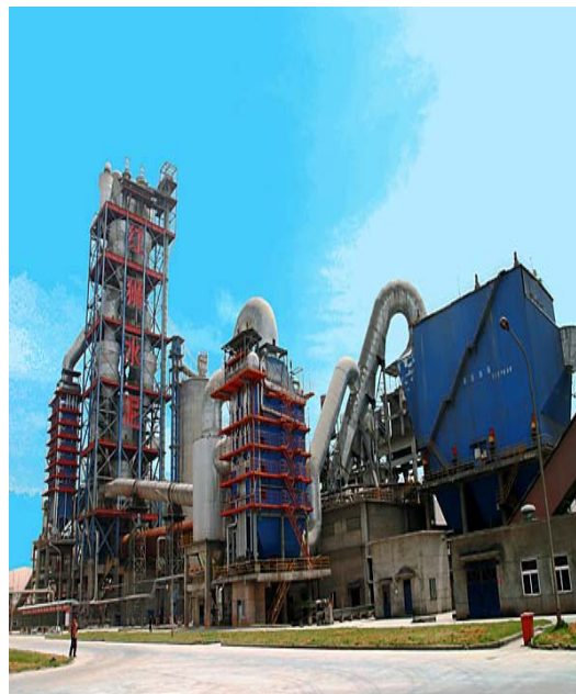
水泥窑余热锅炉
