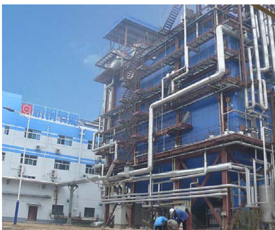
烧结机余热锅炉
