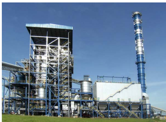
循环流化床锅炉
