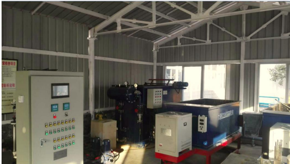
华骏污水处理站内部
