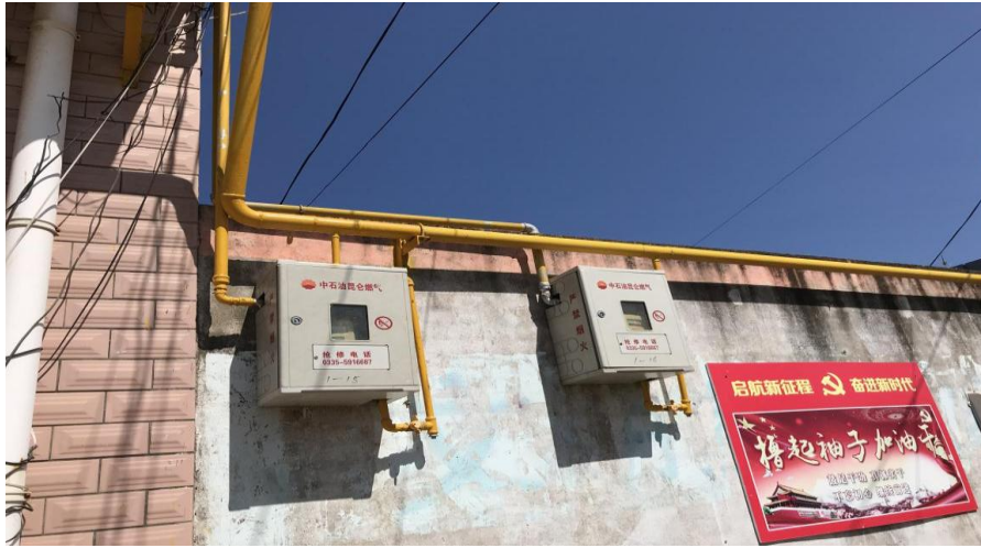
图 5：为昆仑能源河北下属企业煤改气项目
