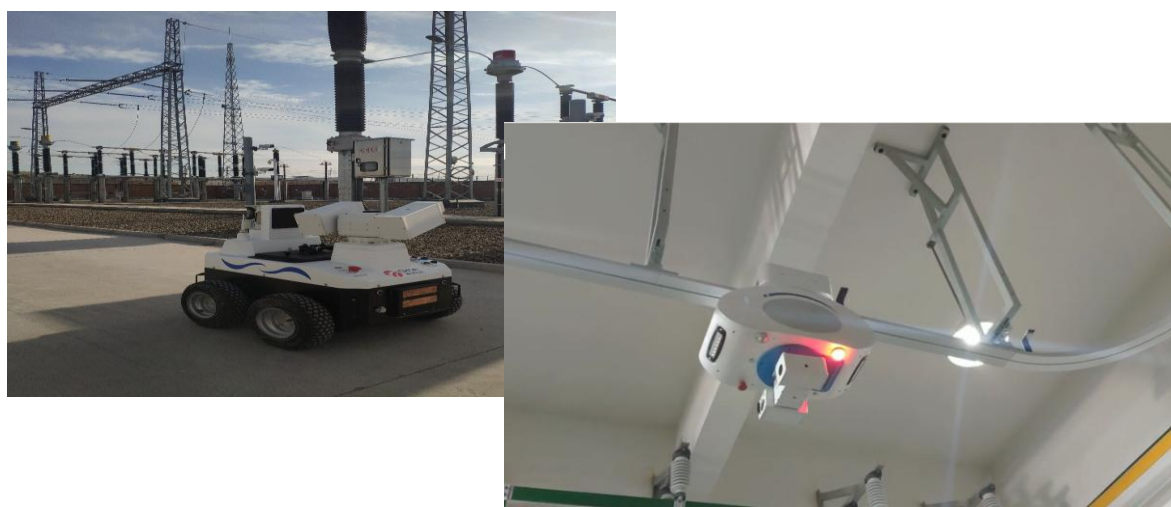
图：变配电所智能巡检轮式机器人
