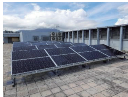
香港产业园光伏电站
