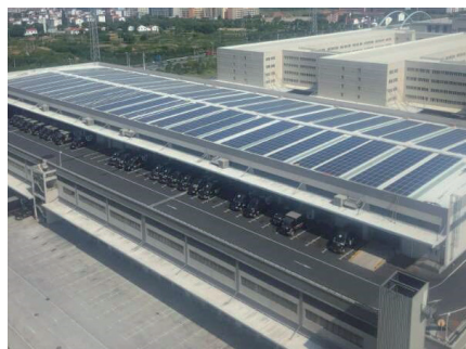
义乌产业园光伏电站
