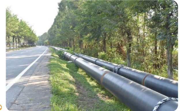
芦苞至大塘天然气高压管道
