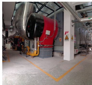
世源热能项目锅炉系统
