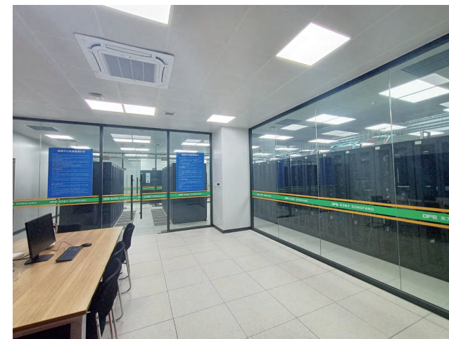
数据中心机房
