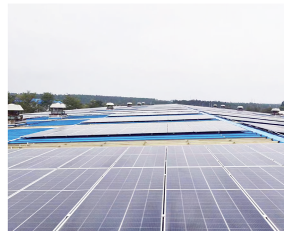
▼ 寿光晨鸣光伏项目
