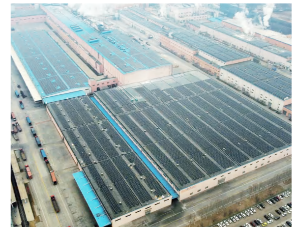
▼ 湛江晨鸣光伏项目
