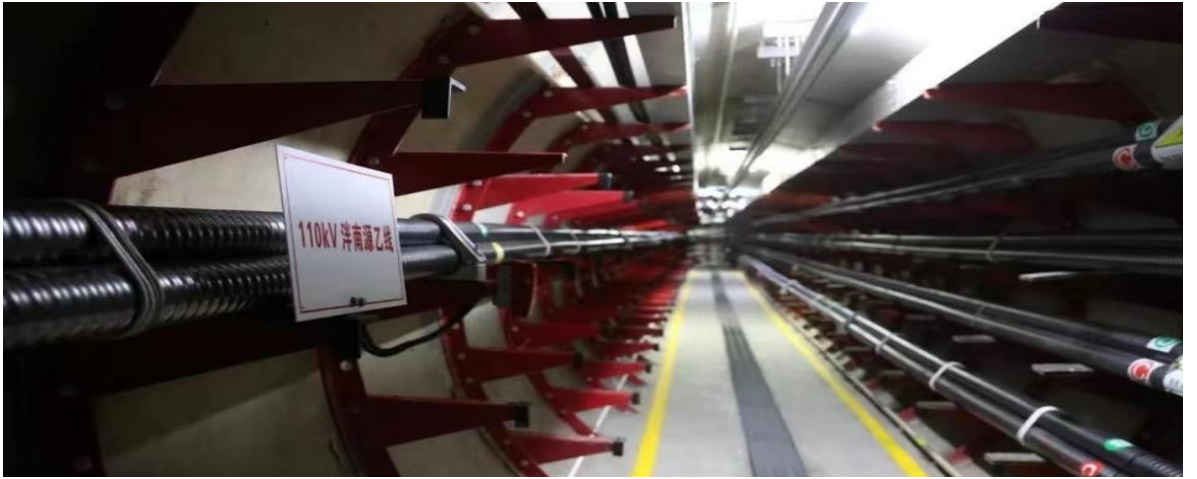
图：110kV 聚丙烯电缆线路
