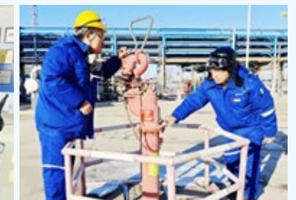
北化分公司加强现场消防设施检查
