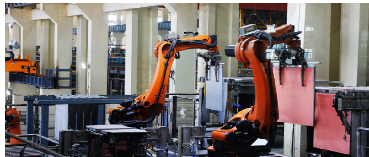
金冠铜业分公司电解车间机器人剥片机组
