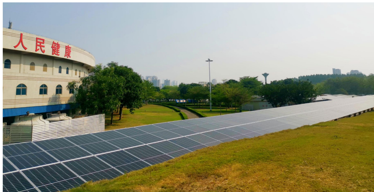
海口市制药厂光伏发电
