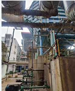
循环冷却水串用到 EP
