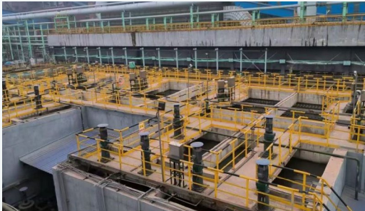
污水处理高密池
