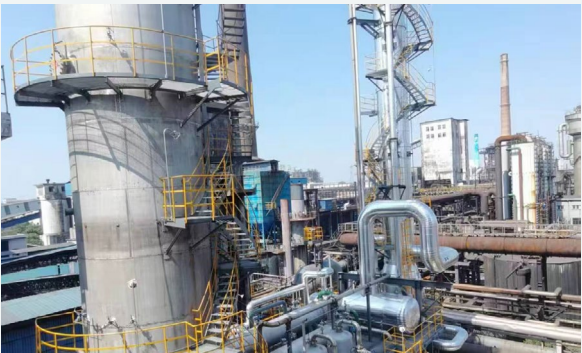
华菱湘钢焦炉煤气精脱硫项目
