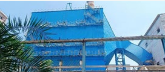
烧结机头电除尘
