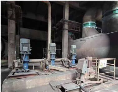
8# 高炉 F 泵水回用
