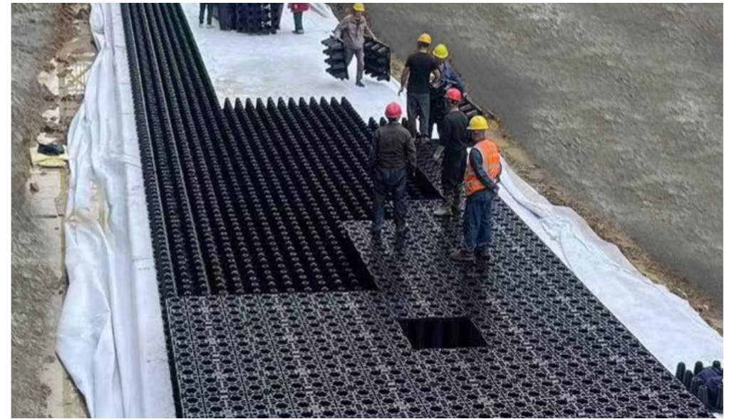
扬州数智城项目住宅雨水收集回收池
