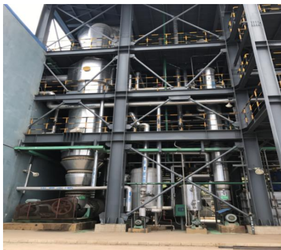
锡业分公司污水 MVR 蒸发系统
