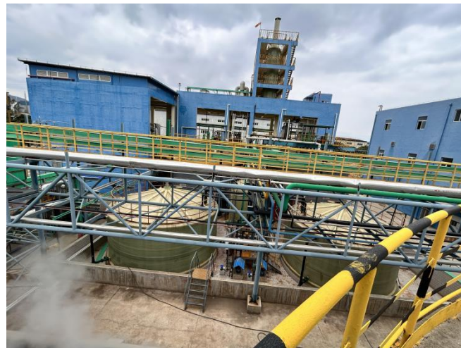
铜业分公司污酸废水深度处理系统
