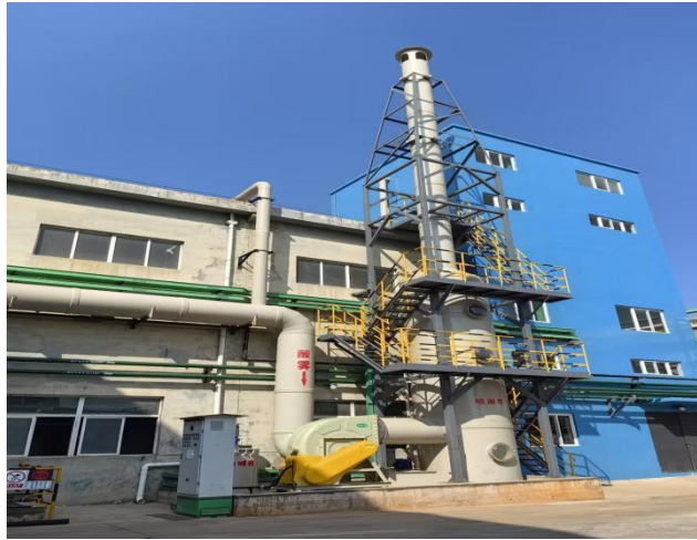
铜业分公司白烟尘处理工序废气治理设施
