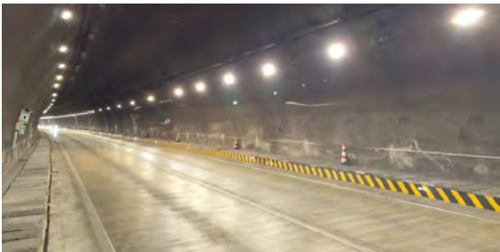
招商中铁岑兴、岑梧高速隧道照明
