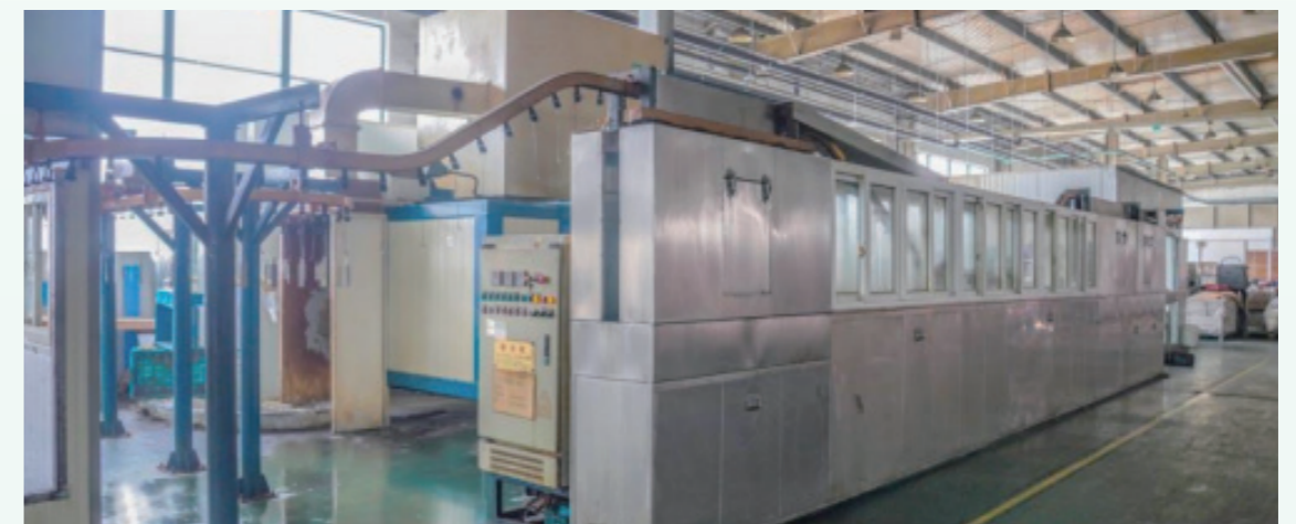
废气处理设施
