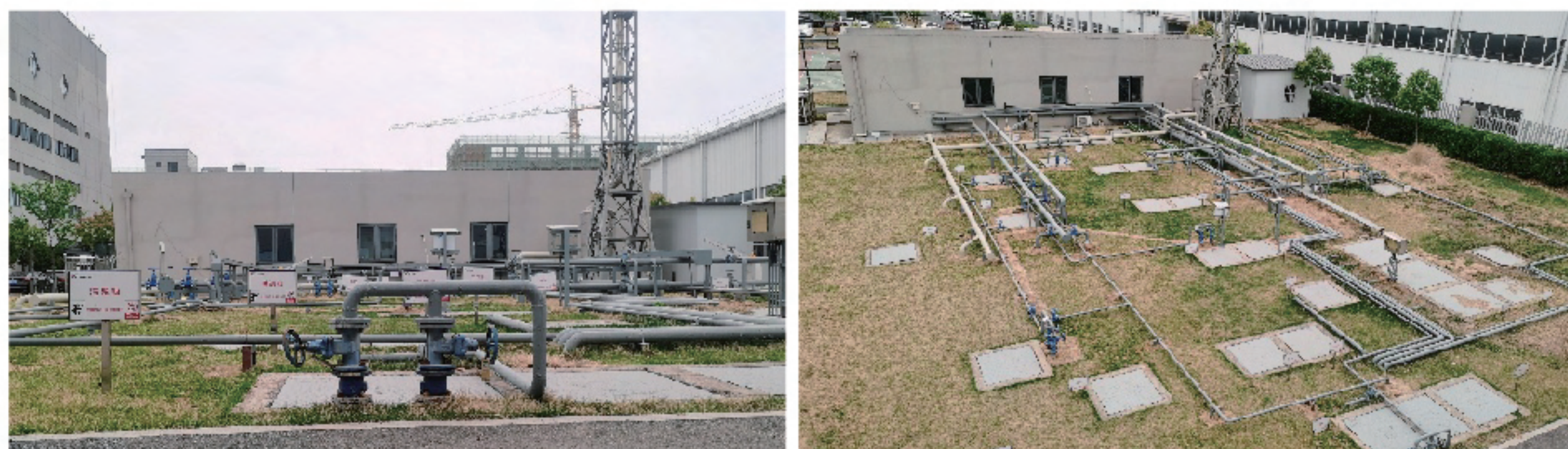
图：亿帆制药污水处理站
