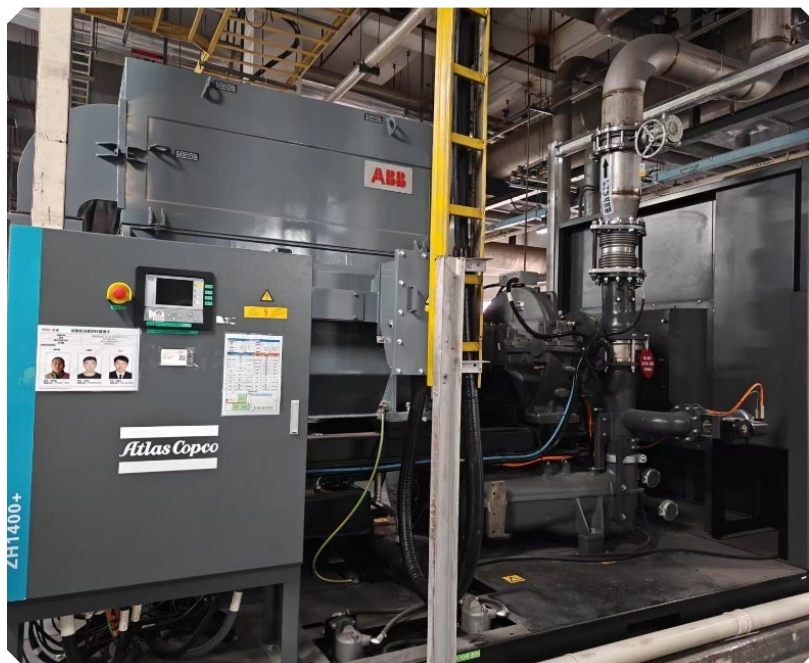
TCL 华星武汉基地空压机系统优化项目
