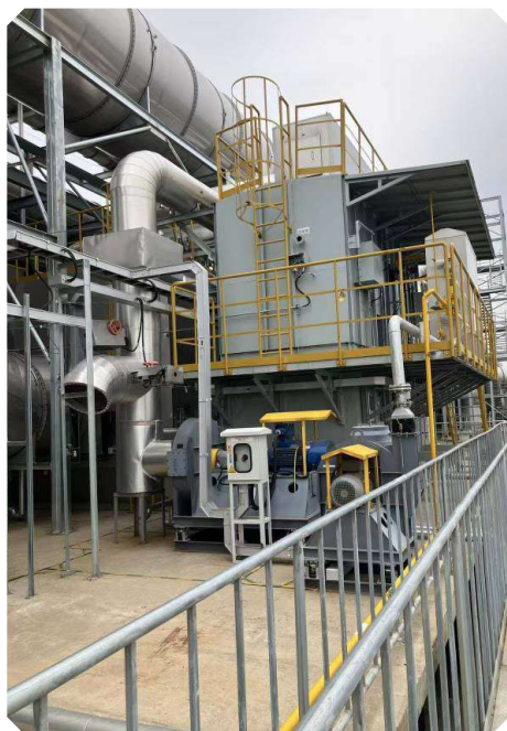
TCL 华星武汉基地 RTO 汰换项目
