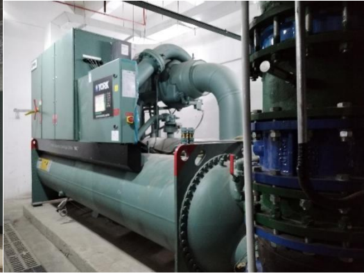
【磁悬浮中央空调】
