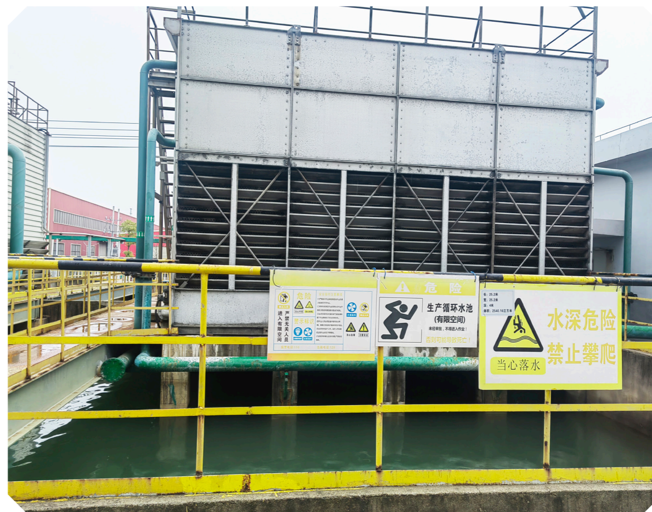
江西中矿锂业循环水设施
