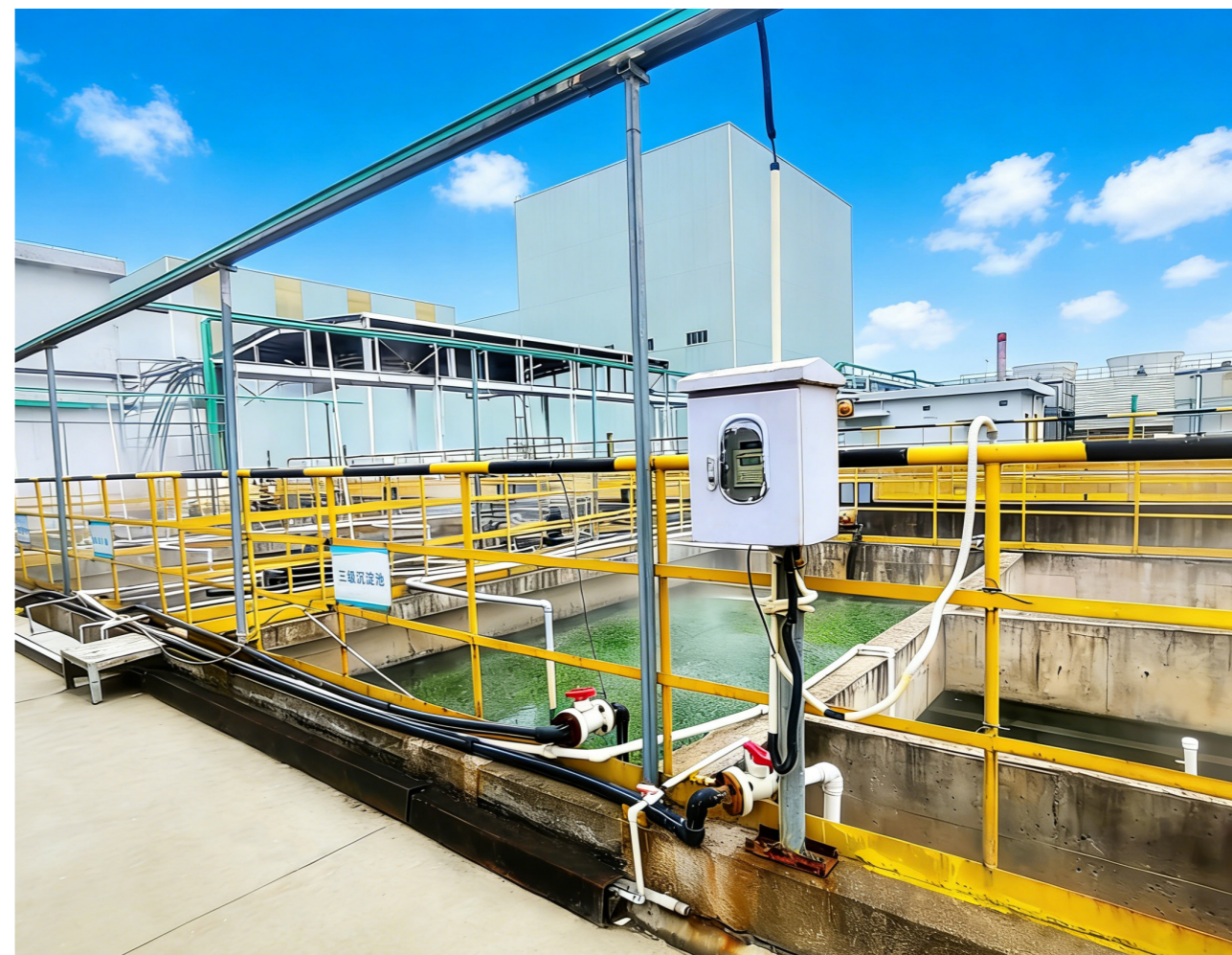
江西中矿锂业一厂污水处理系统
