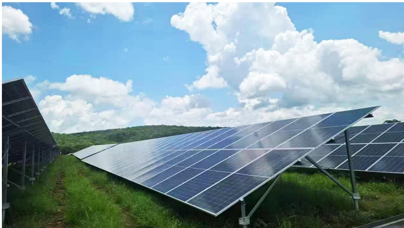
Kitumba 一期 50 兆瓦光伏电站
