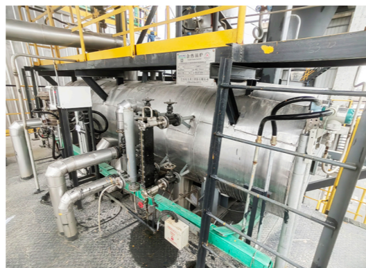
江西中矿锂业“3万吨高纯锂盐技改项目”余热利用锅炉
