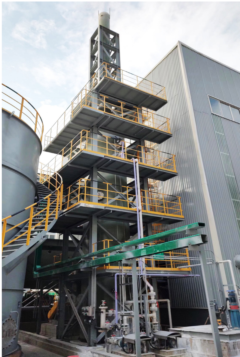
江西中矿锂业浸出制浆废气处理设施
