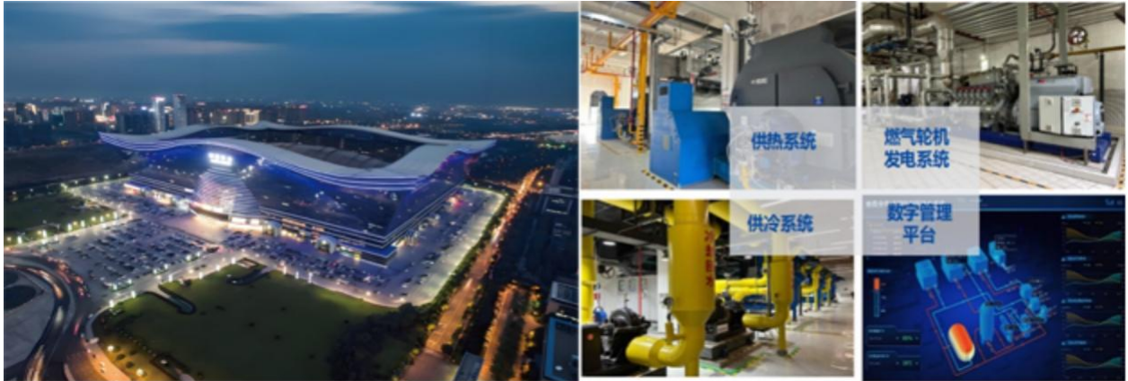
图 5：成都世纪新能源天然气冷热电三联供分布式能源项目
