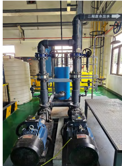
二期废水泵及出口管道
