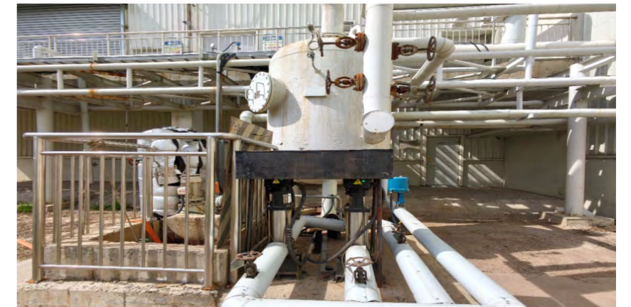
对外供汽管道
