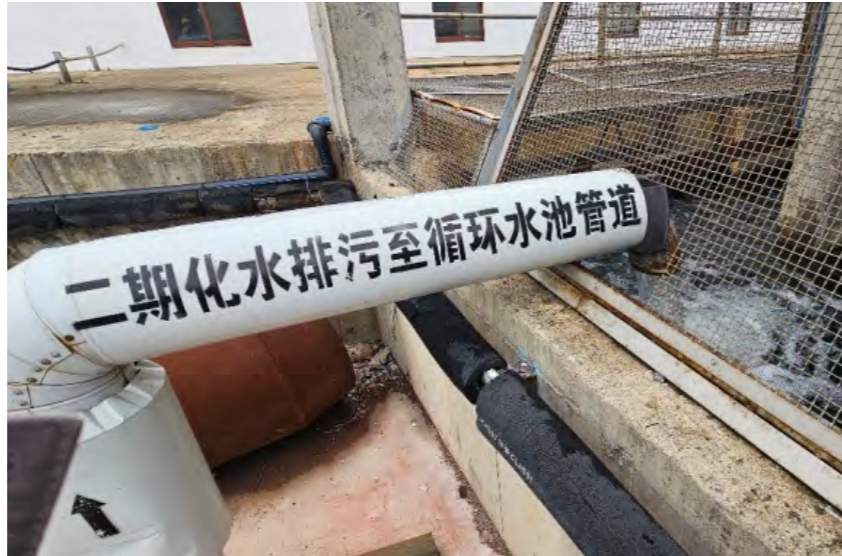
二期化学废水至凉水塔补水管道
