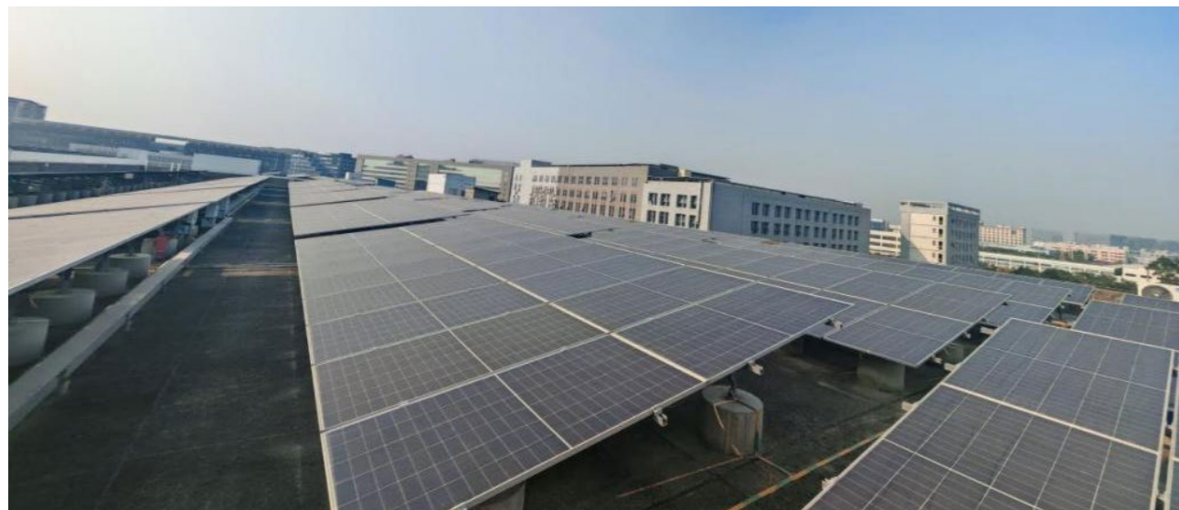
三灶厂房项目屋顶光伏
