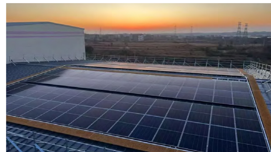
屋顶光伏照片
