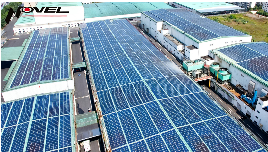
黄山包装厂区天面分布式光伏项目实景
