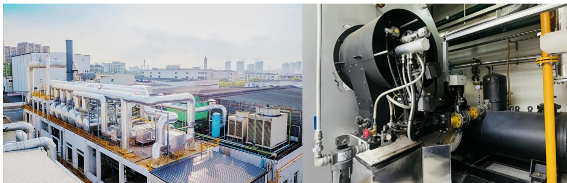
溶剂回收废气治理项目与锅炉废气治理项目
