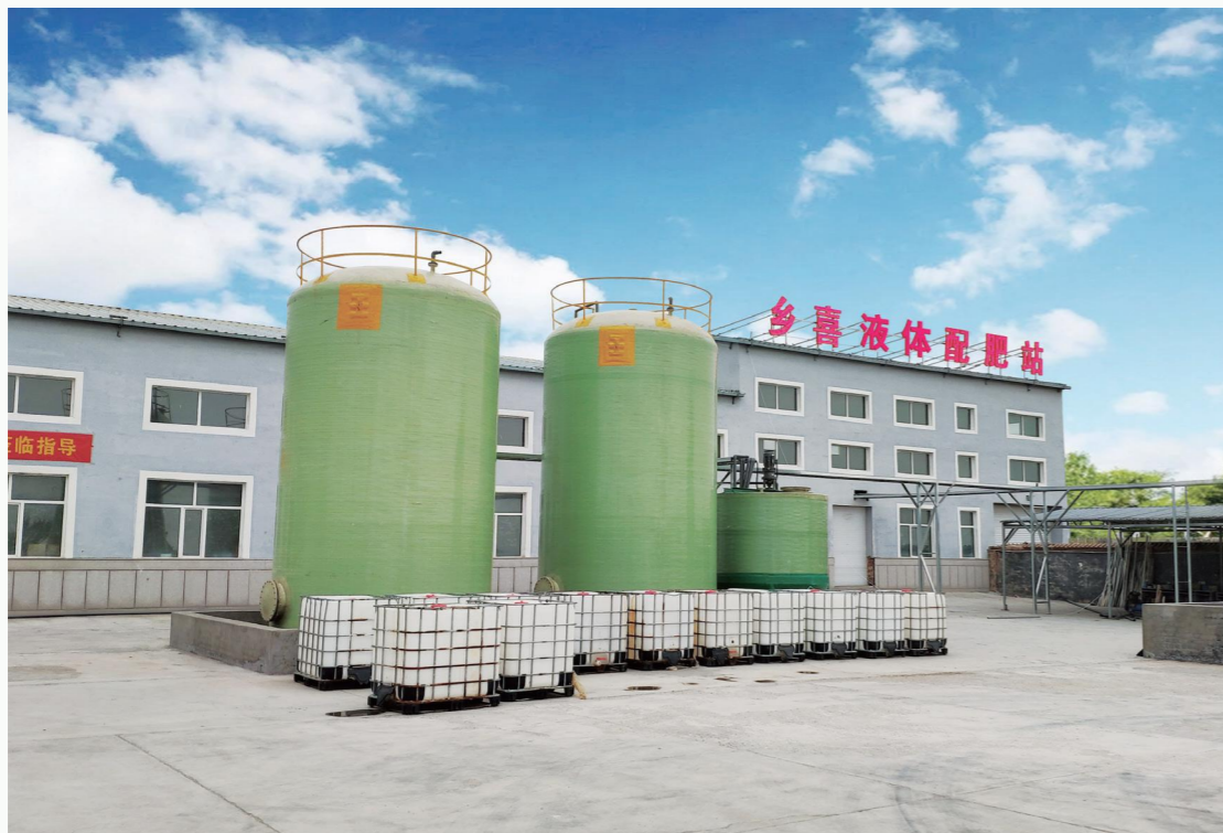
东莞一翔公司建设的液体配肥站
