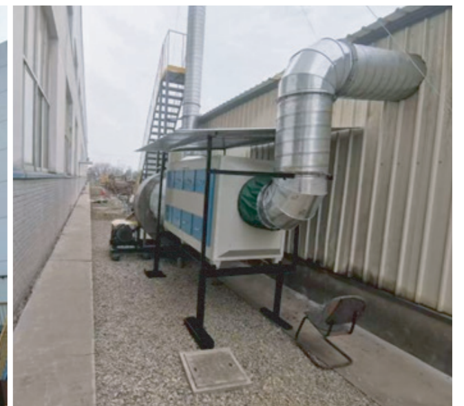
危废库废气收集设备
