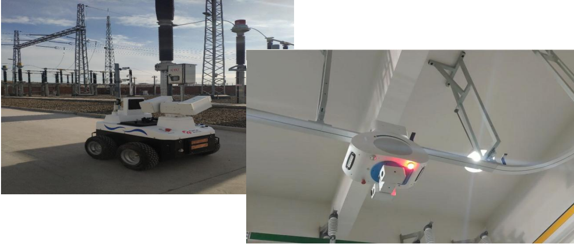
图：变配电所智能巡检轮式机器人
