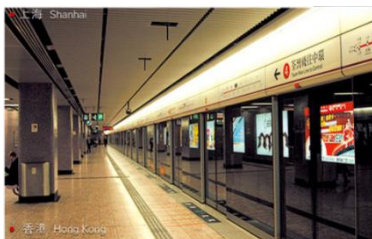
上海地铁中使用公司的 防火防爆地铁屏蔽门系统
