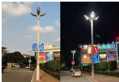
东莞市谢岗镇智慧灯杆项目
