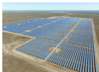
比亚迪太阳能南非地面电站
