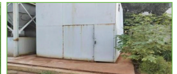
增加隔音防护罩的除尘器风机
