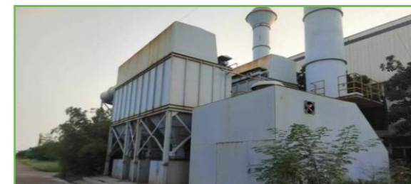
增加隔音防护罩的除尘器
