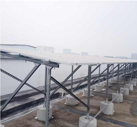
屋顶光伏（局部）
