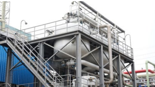
二氯甲烷废气耦合治理设备
