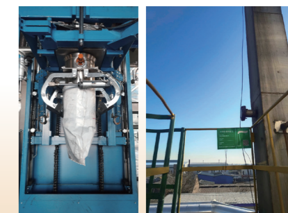
安全隐患排查整改
