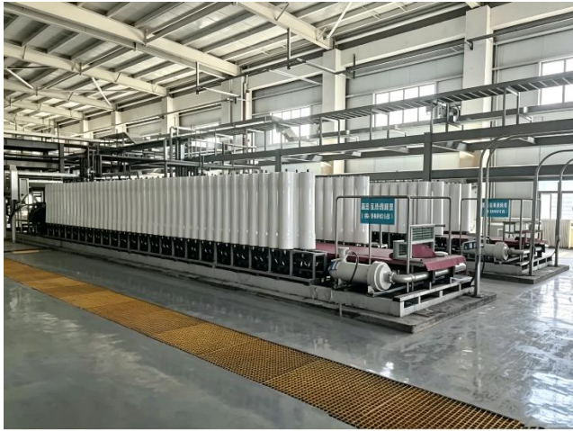
新疆氯碱化工高盐废水处理项目
